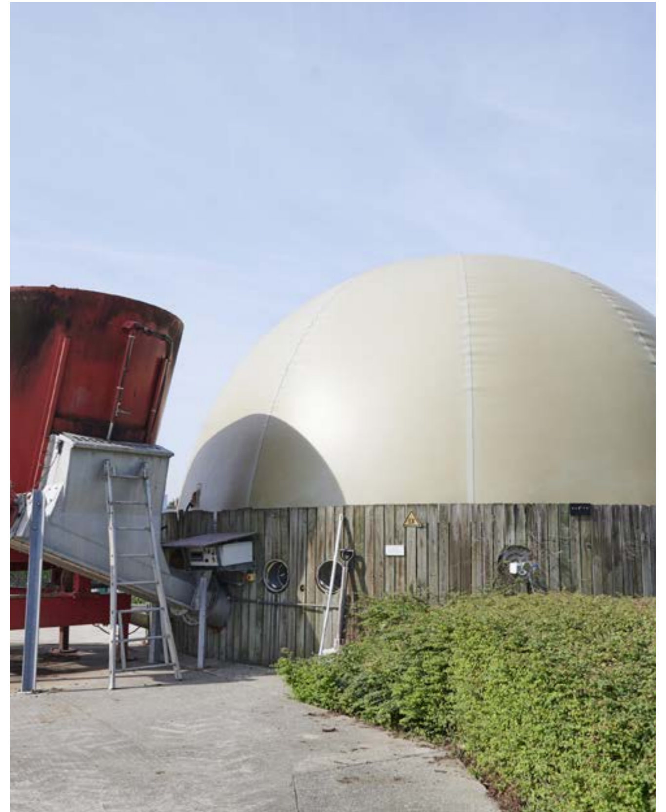
▲ Inagro. Biogas installatie. Bron Foto © INAGRO. https://inagro.be/research-and-demo-platform-anaerobic-digestion
