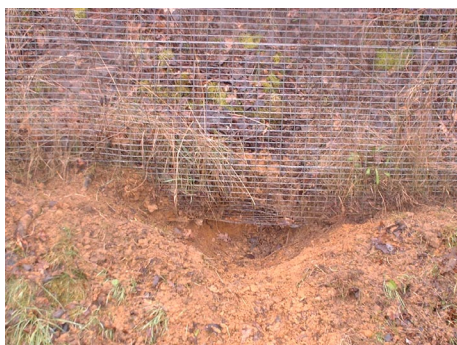
Figuur 5.13 Raster is ondergraven; sluit niet meer op maaiveld aan.
