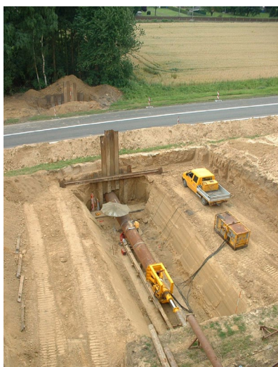
Figuur 4.10 Boorput van een OFT (Open Front Techniek)
