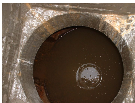
Figuur 5.9 Inspectieput vol met water.
