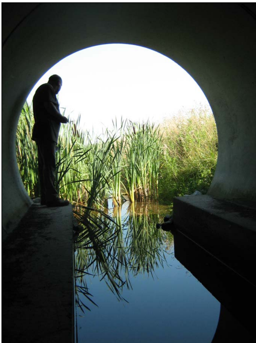
Figuur 14: regelmatige controle van merkplaatsen en veelgebruikte passages – zoals de ecoduiker van de Muntbeek onder de Vlamingstraat – kan uitsluitsel geven over de aanwezigheid dan wel migratie van welbepaalde soorten
