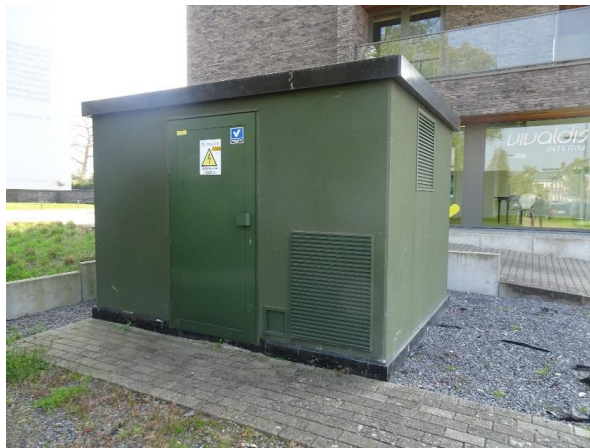
Figuur 1: Foto van de buitenzijde van de cabine gelegen in de Zwijnaardsesteenweg te Merelbeke.
