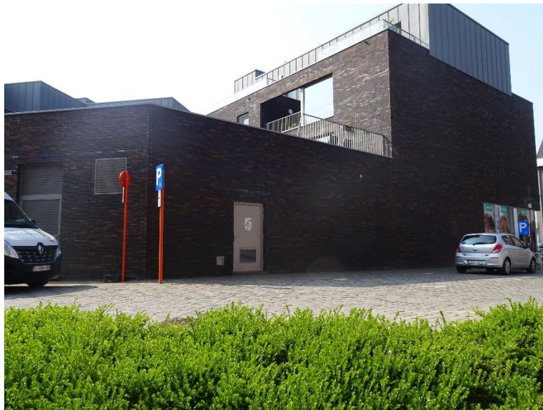
Figuur 1: Foto van de buitenzijde van de 12 kV cabine gelegen aan de Hundelgemsesteenweg in Merelbeke.
